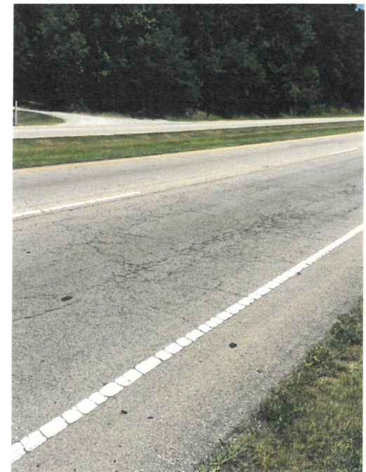
Alligator Cracking (Mill/Fill)
